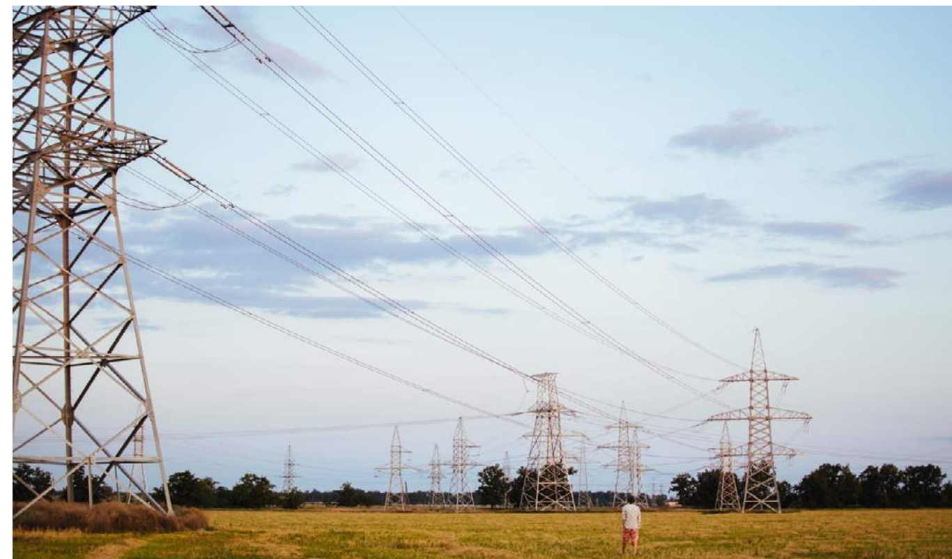
Ligne haute tension
