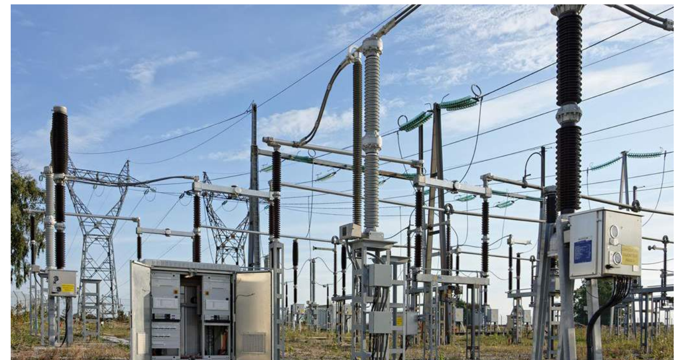
RTE poste électrique intelligent blocaux
