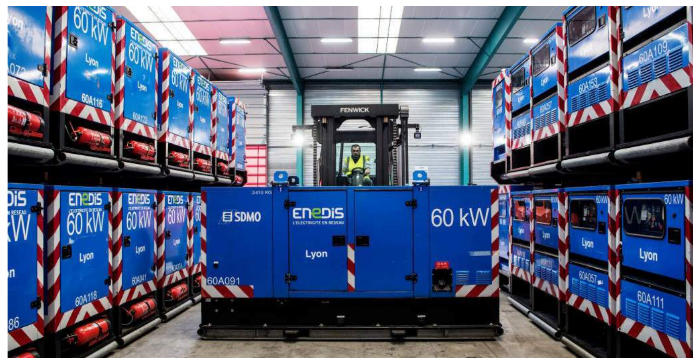
Entrepôt de stockage de batteries Enedis
